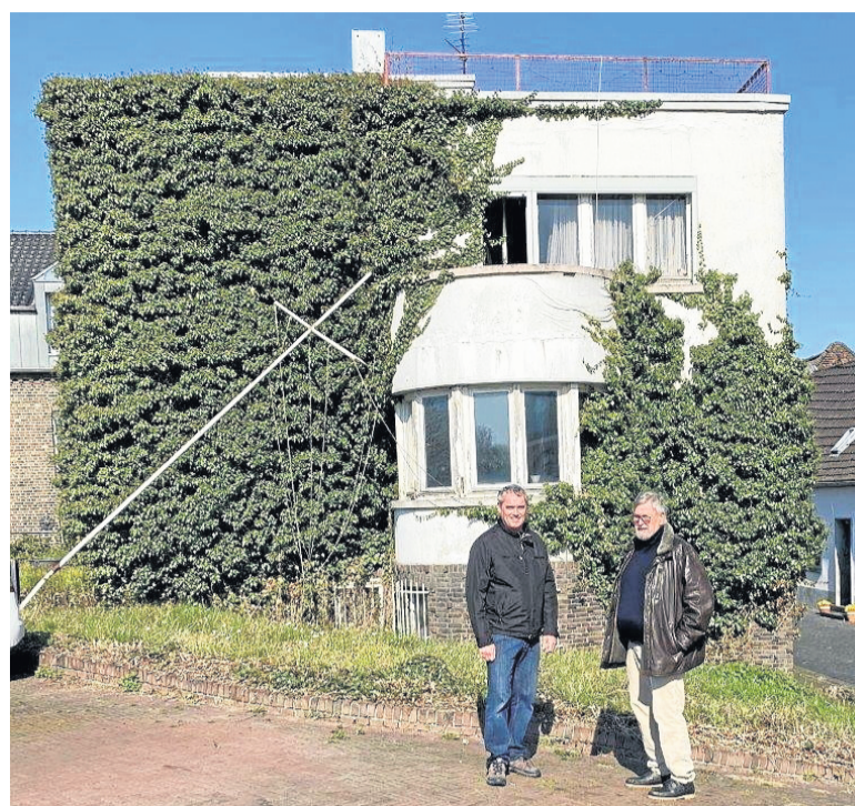
Haus Haan in Grieth verkommt, Jochem Reinkens und Thomas Verfürden vom Arbeitskreis kritisieren den Zustand.
