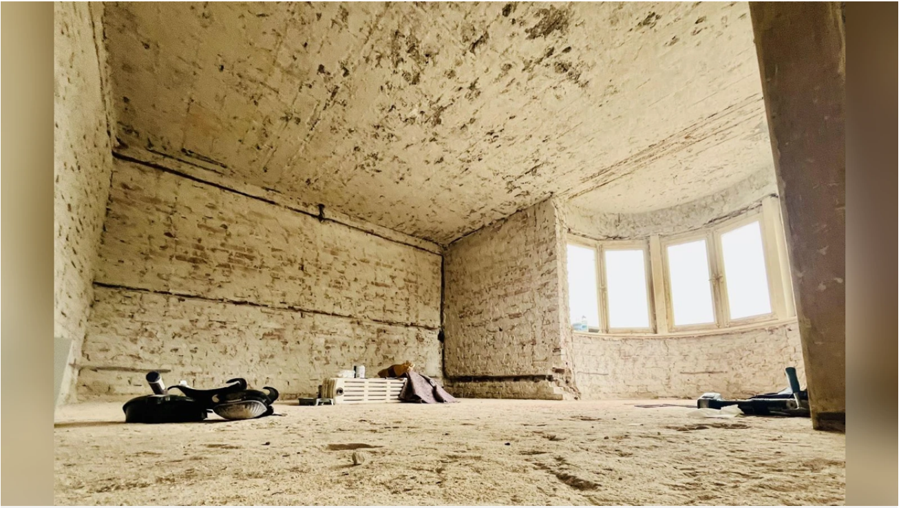
Das Herrenzimmer im Haus Haan. Überall wurde der Putz von den Wänden geholt.
