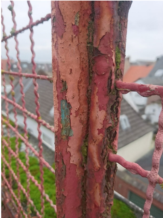
Geländer der Dachterasse mit Blaubefund
