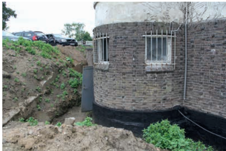
Das aufwendige Mauerwerk des Kellergeschosses und die handwerkliche Raffinesse der vergitterten Fenster
